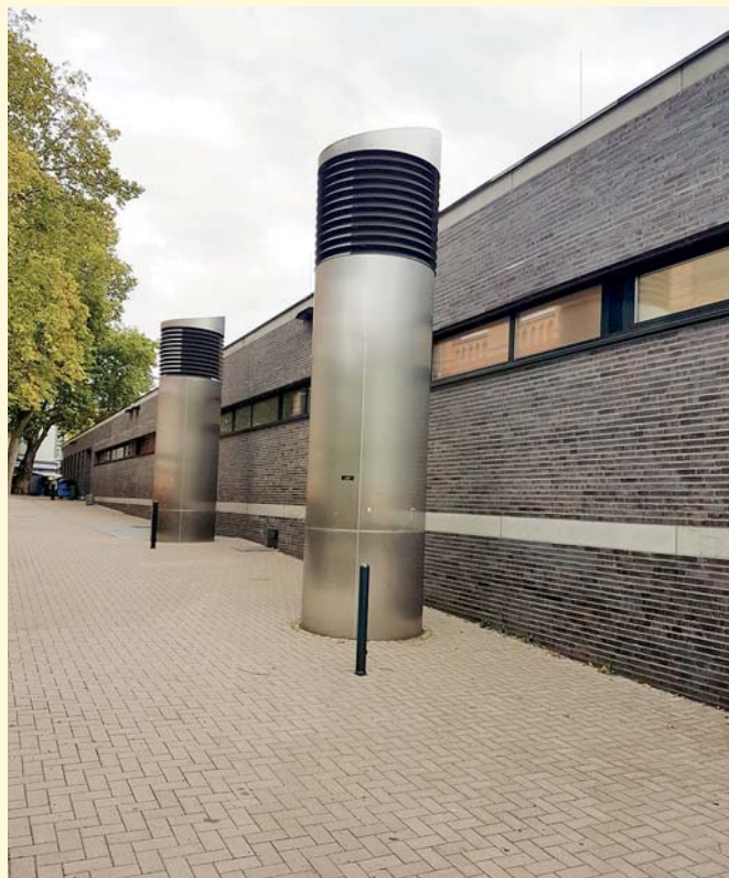
Ansaug- oder Lüftungtürme sorgen beim Landesstützpunkt Düsseldorf für die Versorgung der Lüftungsanlage mit frischer Außenluft
